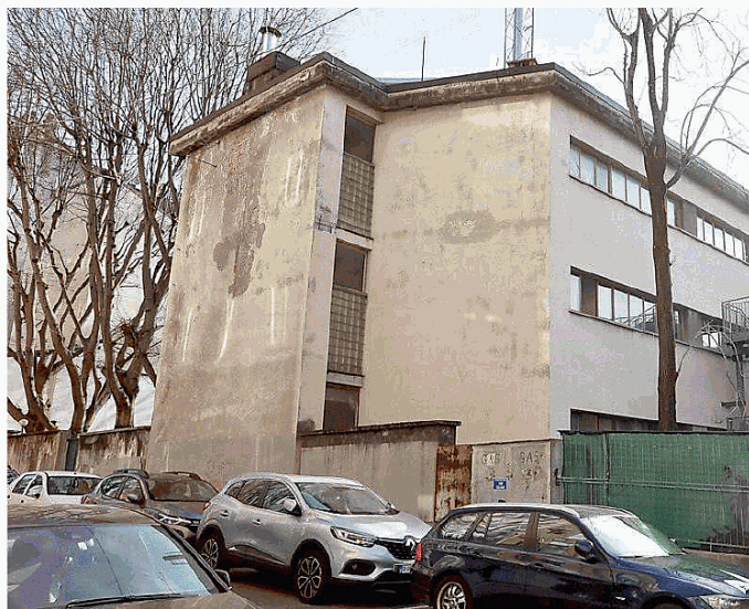
La macchia di umidità delle perdite nel bagno della scuola Pittoni si vedono anche all'esterno FOTO LASORTE
